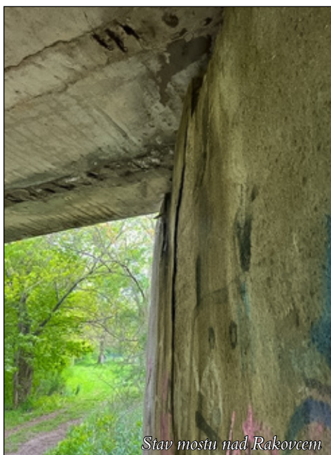
Stav mostu nad Rakovcem
